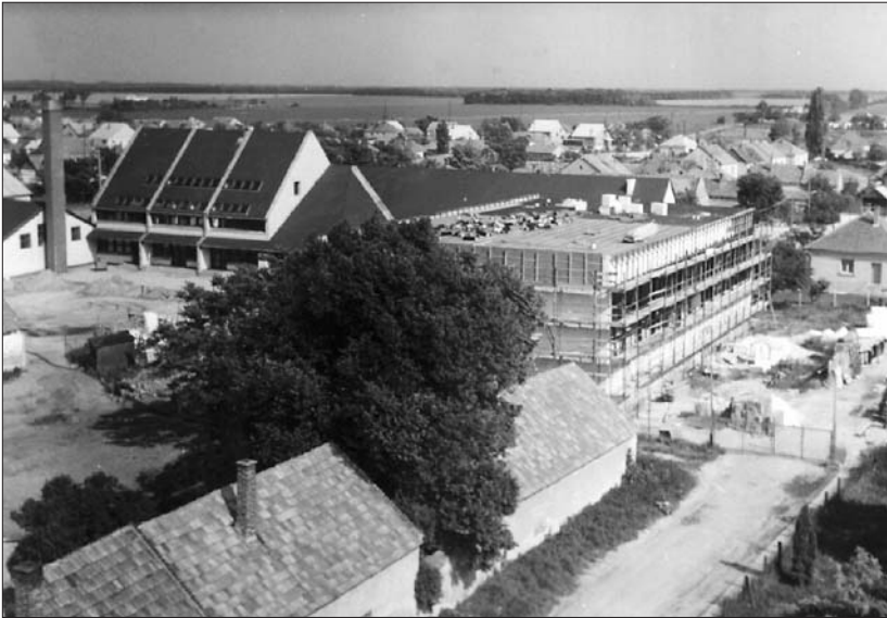
27. kép. Jánossomorjai sportcsarnok építése 1986-ban (Birkmayer György tulajdona) / Bau der Sporthalle in St. Johann 1986 (Besitz: György Birkmayer)
