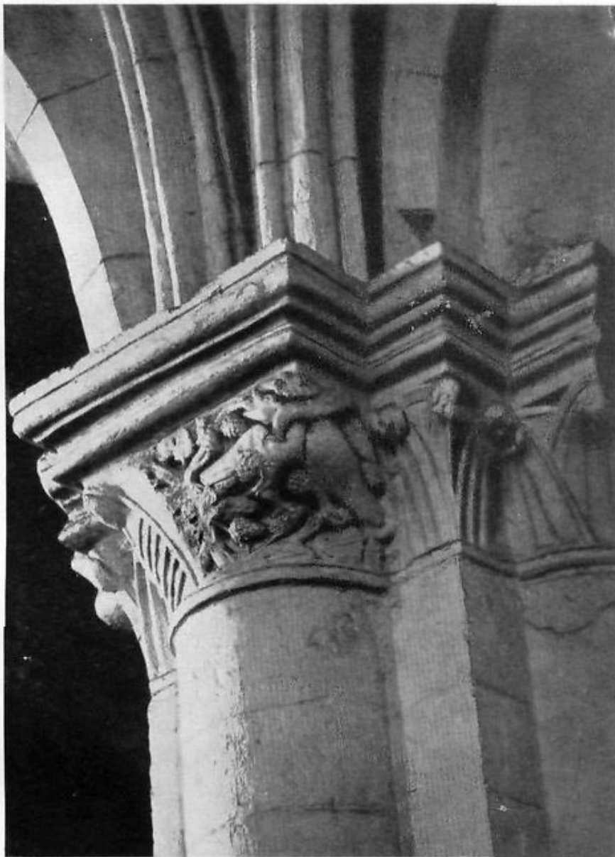
170. kép. A 29. sz. pillérfő helyreállítás előtti állapota
