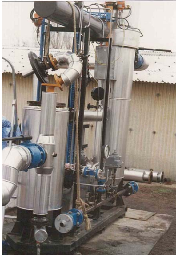
28.4 A beüzemeltetett olajkúthozaméró berendezés. Algyő, 1991.
