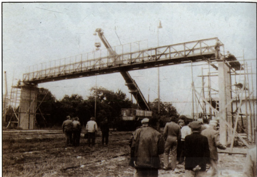
A köbölkúti vasúti gyalogos felüljáró 29 méter hosszú acél áthidalásának elhelyezése. Kivitelező: Agrostav Nové Zámky, 1993. október
