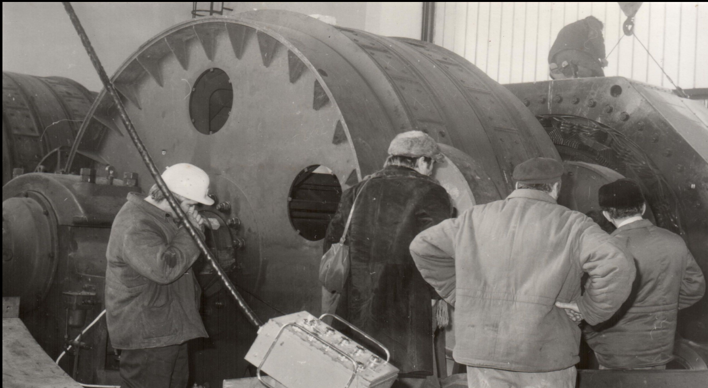
Az V-ös szállítóakna északi szállítógép 2,2MW-os motor beépítése. Elől a koope tárcsa látható, ez két bakcsapágyon állt, és a nyugati oldali csapágyra volt felépítve a 29 tonnás motor forgórésze egy tengelykapcsolóval. (A motornak nem volt külön csapágya.)
